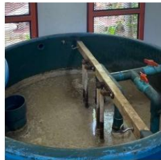
ถัง SUMP I
