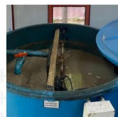
ถัง SUMP II
